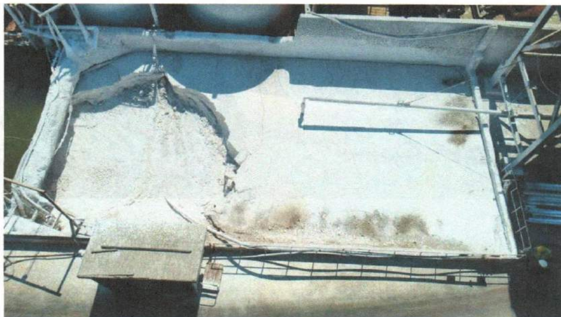
氢氧化钙储存池。
