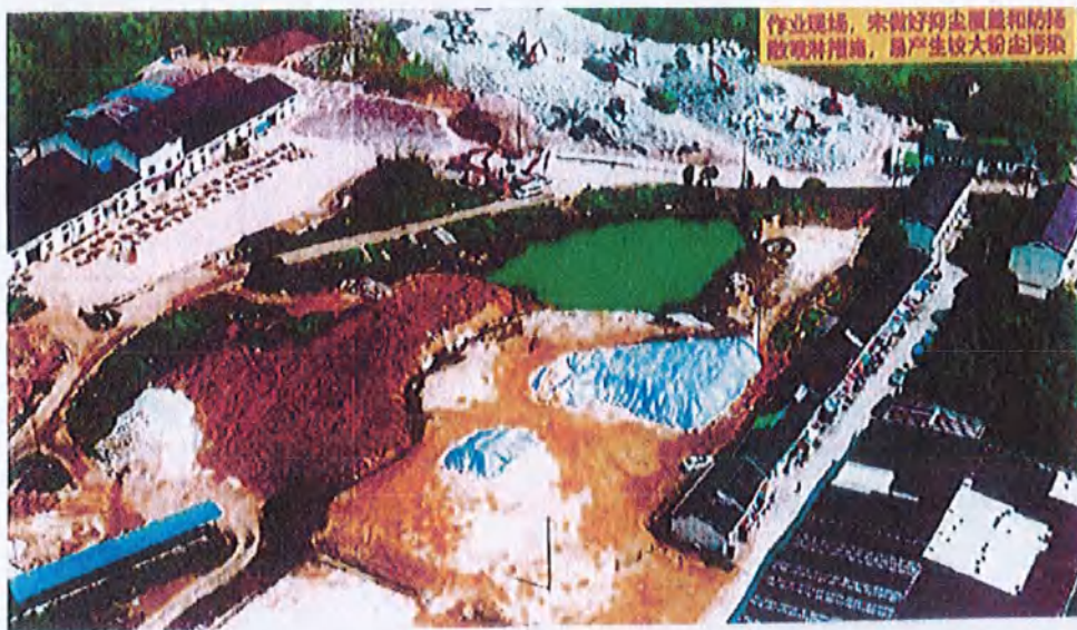
图 9、作业现场，未做好抑尘覆盖和防扬尘喷淋措施，易产生较大粉尘污染
