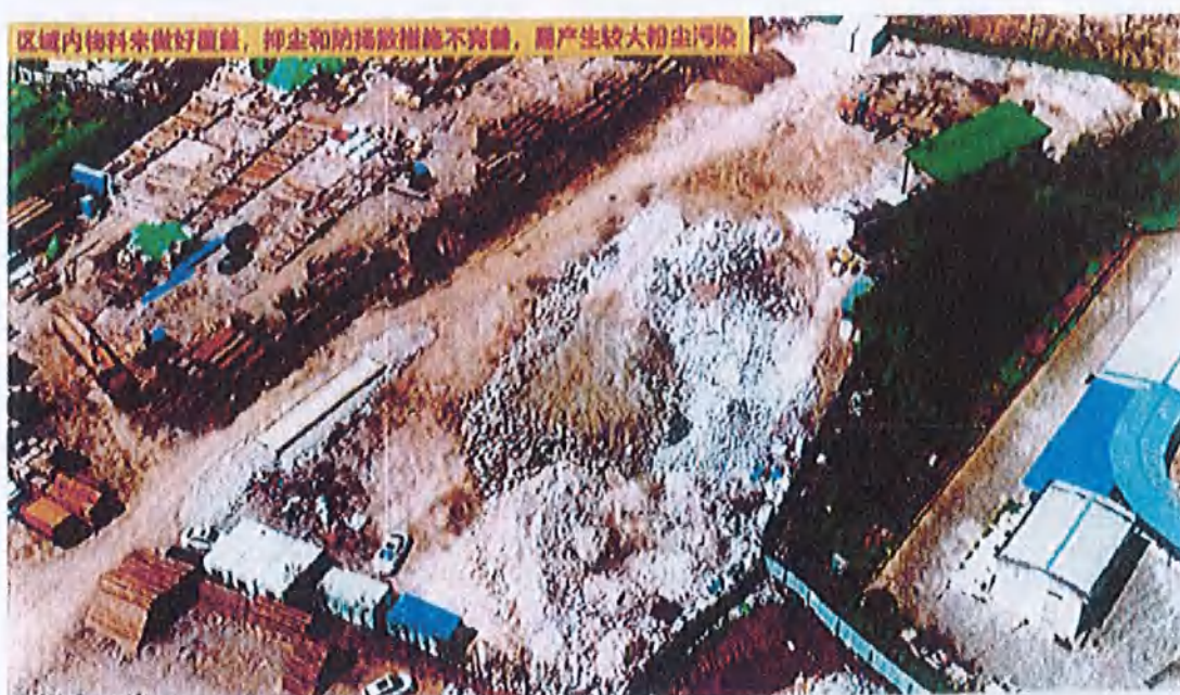
图 7、区域内物料未做好覆盖，抑尘和防扬尘喷淋措施缺失，易产生较大粉尘污染
