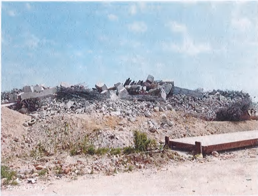
图 8 红色圈出部分混凝土破碎场地实拍图
