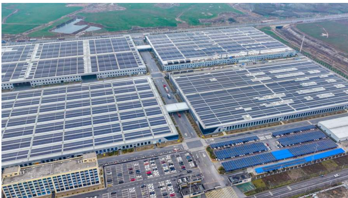
图 4-13 晶科能源（滁州）有限公司屋顶光伏
