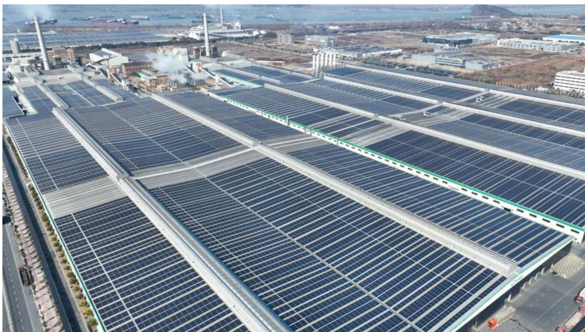
图 4-8 信义光能控股有限公司屋顶光伏 60
