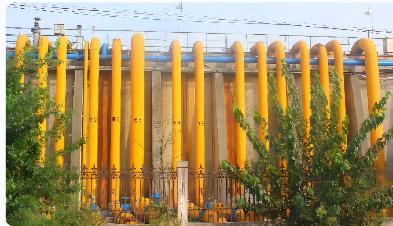
图 70：党湾污水处理厂各企业废水进水管道
